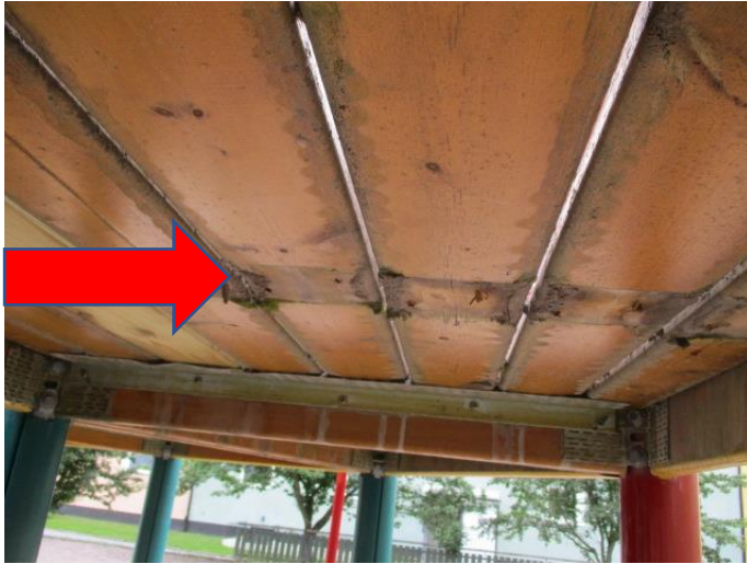
Här har en träregel under plattformen lossnat. Plattformen blir givetvis försvagad.
